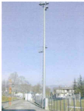
Figura 123 - Palo di illuminazione del campo sportivo
