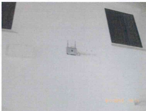
Figura 146 - AP indoor attualmente installato
